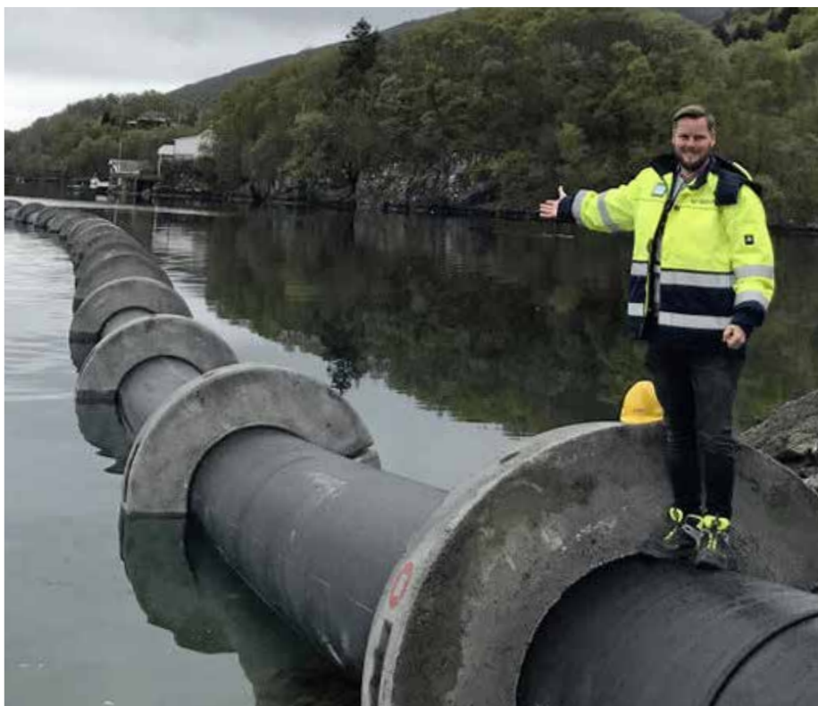
BKK har satset stort på fjernkjøling basert på sjøvann i Bergen.
