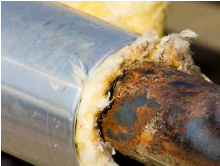
Korrojonsskader under isolasjon koster den globale økonomien flere milliarder hvert år.
